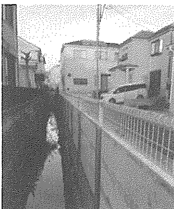
実績 4 赤堀陽水の水路に逸水防止壁設置 (源左衛門新田43付近)
