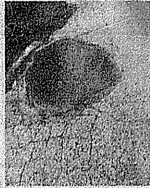
③石神のわかざテニスクラブのコート付近 道路陥没の舗装
